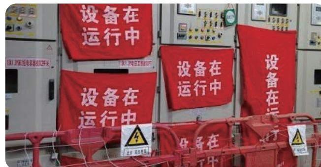
图 6 带电 10kV 开关柜上的围栏和标志牌设置
