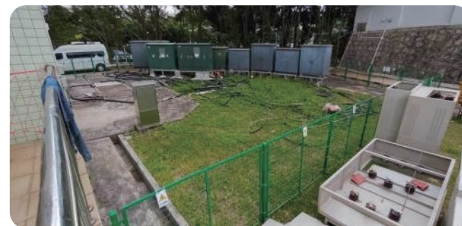
图 7 10kV 线路转接箱四周围栏设置
