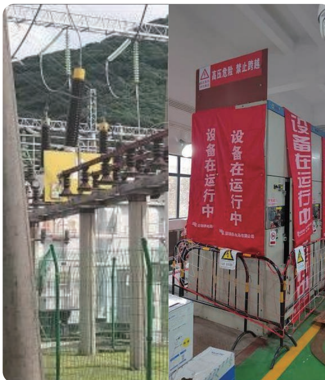
图 5 隔断点顶部不带电一侧安装绝缘挡板
